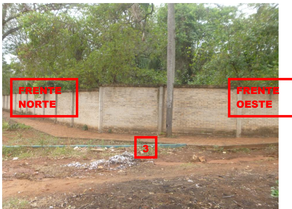
Foto N° 25: Vista General de la propiedad desde la esquina de las calles Prof. Rosa Masi y José Cataldi (se observan el vértice 3 , la muralla de ladrillos comunes con pilares de hormigón armado, el tipo de vegetación existente en ese sector del predio, la ochava, la vereda y el pavimento terraplenado)
